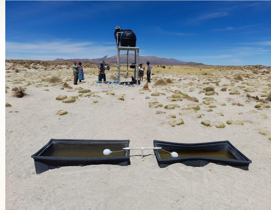
Sistema Fotovoltaico, Comunidad Rosapata. Oruro
